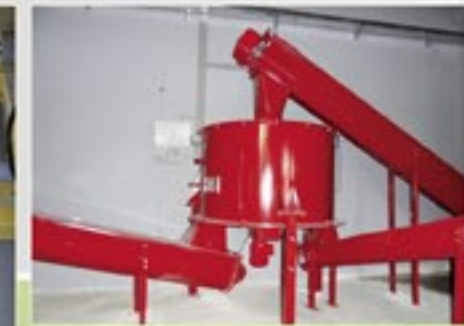
Coclea di salita Gilles, con contenitore intermedio per l'alimentazione contemporanea di due caldaie.
